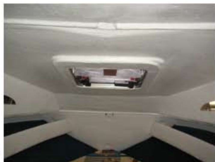
Techo de la cabina Con escotilla practicable
